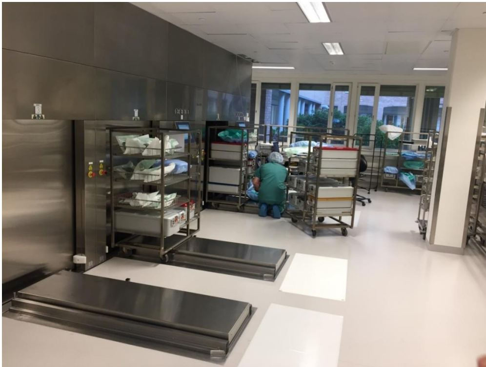
Figur 21: Innlastersiden på autoklavene på Rikshospitalet
