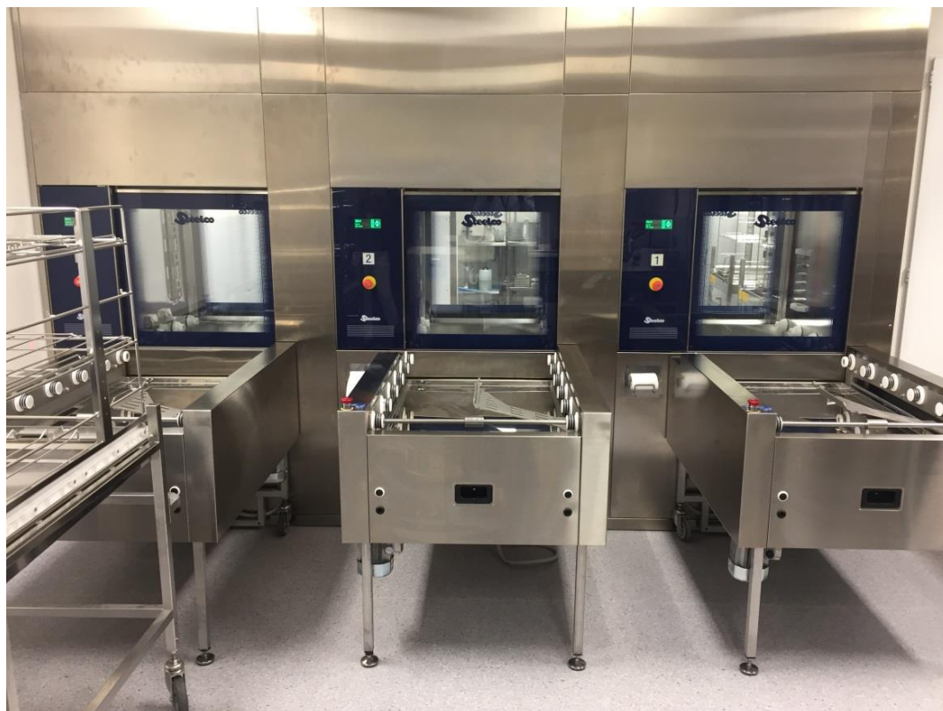
Figur 18: Instrumentvaskemaskiner med lastesystem. Maskinene står i veggen mellom urent og rent rom.
