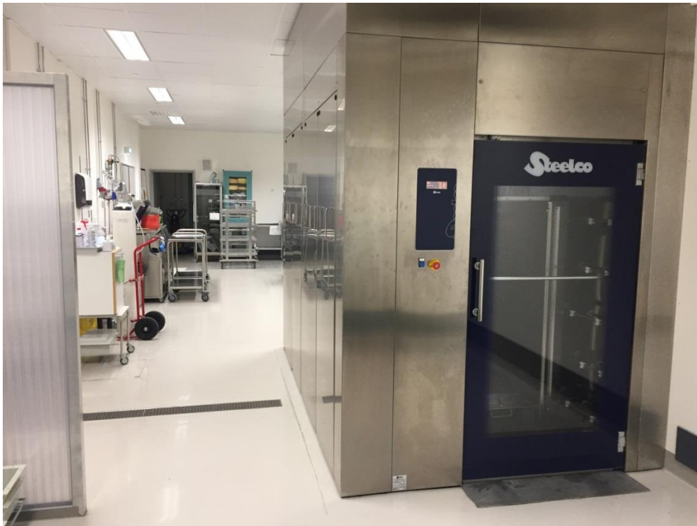
Figur 19: Vognvaskemaskin ved sterillageret på Rikshospitalet.
