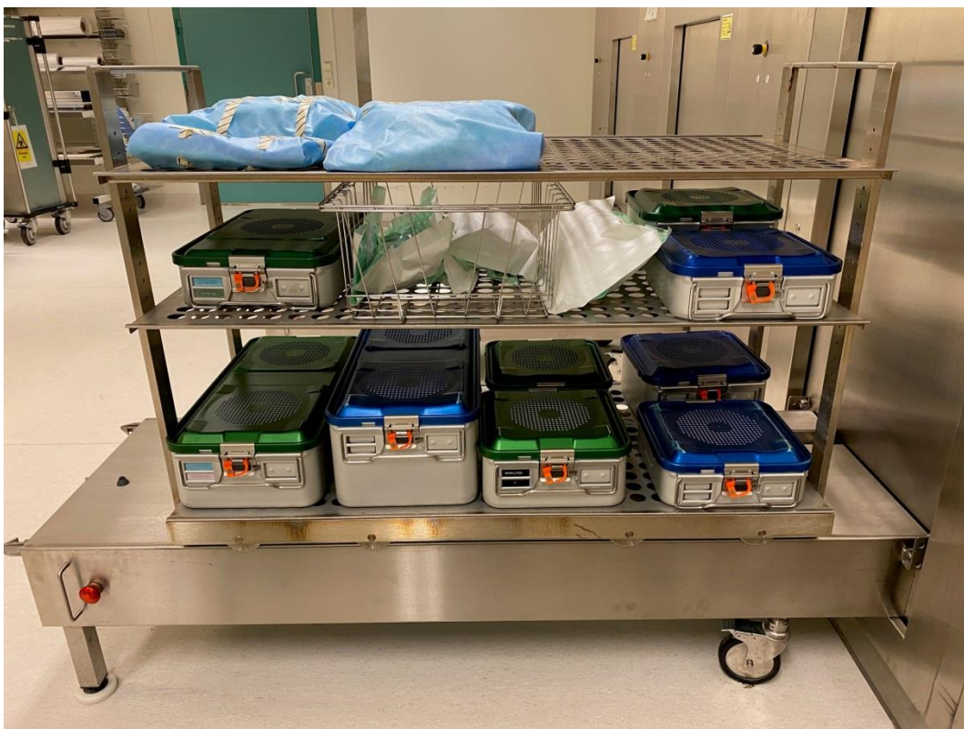
Figur 22: Innlasting av gods til autoklivering Ullevål
